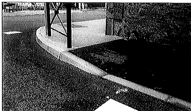
Aménagement d'une dépression en bordure T2 haute variant de 14 cm à 2 cm de vue - BRESSUIRE
